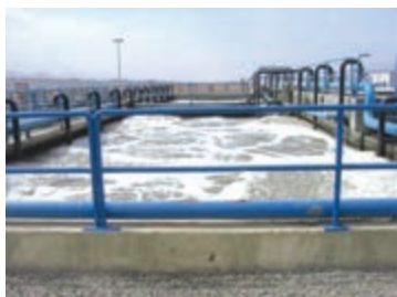
▲ شکل ۸-۲ تصفیه خانه آب
