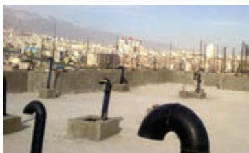
شکل ۲-۵۳ لوله‌های هواکش روی پشت‌بام
