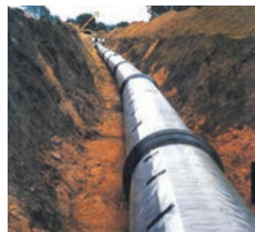
▲ شکل ۲-۲۲ لوله کشی انتقال آب شهری
